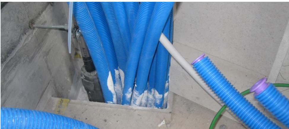
Illustration 9 : Inapproprié : installation électrique en faisceau (source : Haute école de Lucerne – Technique et architecture; photo: 30.11.2013)
