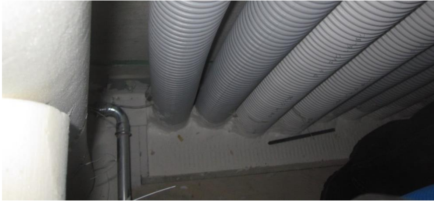
Illustration 8 : Gaines techniques avec installation (source : Haute école de Lucerne – Technique et architecture ; photo: 30.11.2013)
