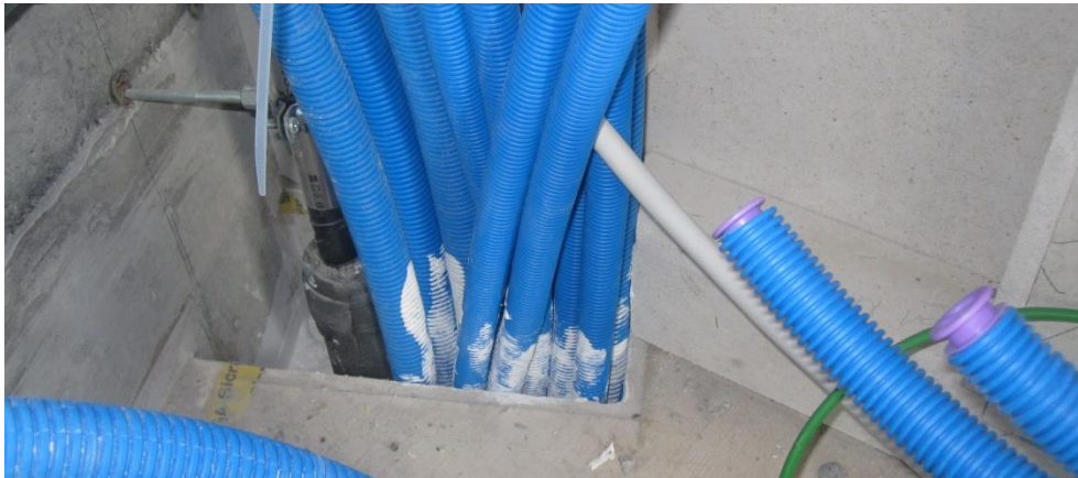
Illustration 9 : Inapproprié : installation électrique en faisceau (source : Haute école de Lucerne – Technique et architecture; photo: 30.11.2013)
